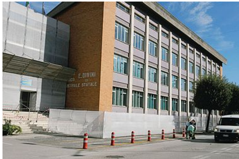
LESIONATO L'edificio che ospita l'Itis Divini, a San Severino; Provincia e Comune stanno valutando soluzioni alternative (foto Calavita)
